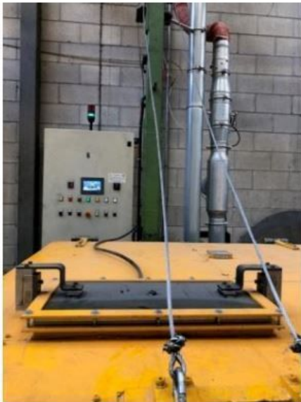
Foto 4: apertura controllata di ventilazione
