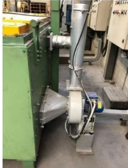
Foto 5: sistema di controllo aspirazione
