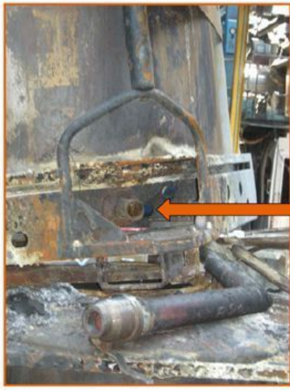
Imbocco della cisterna privo della valvola
