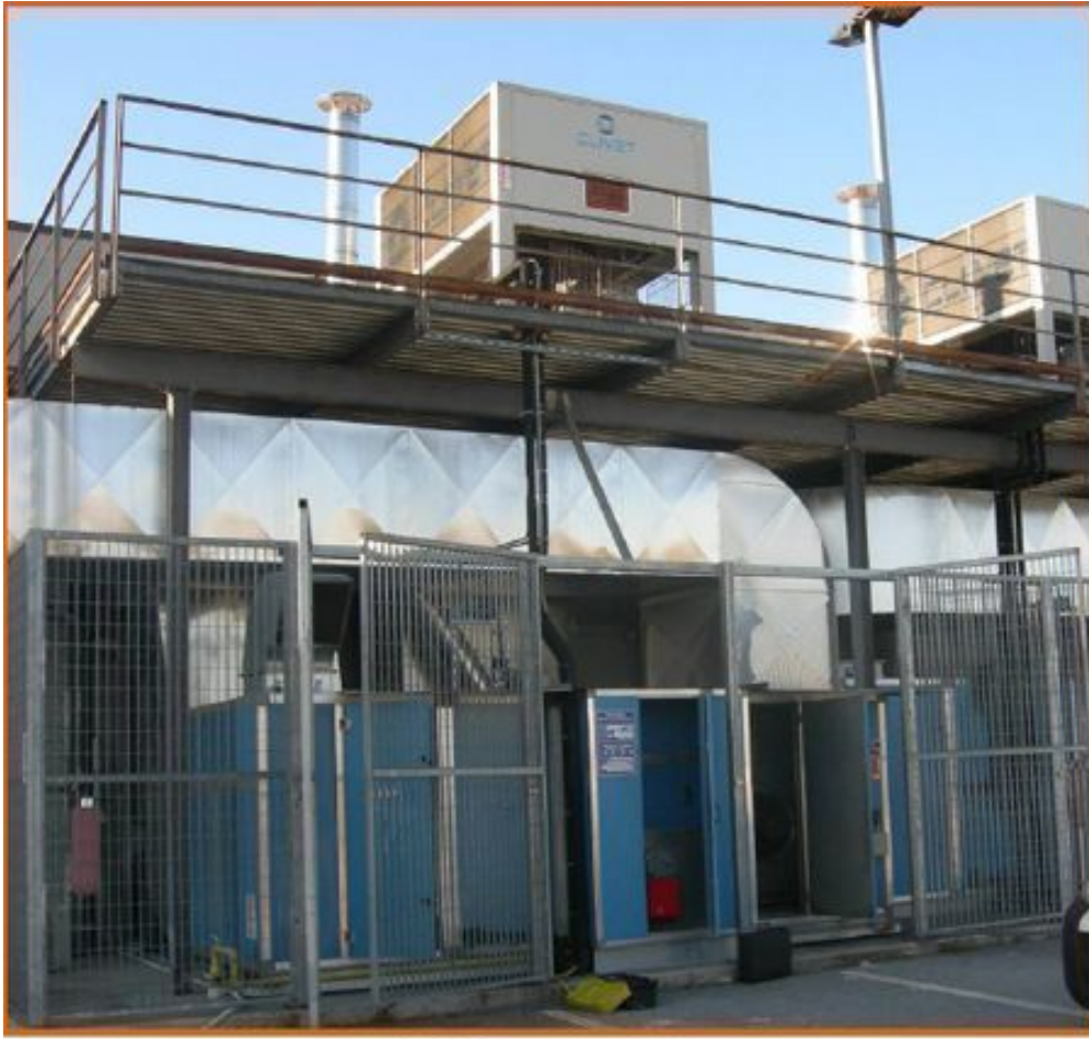
Unità Trattamento Aria
