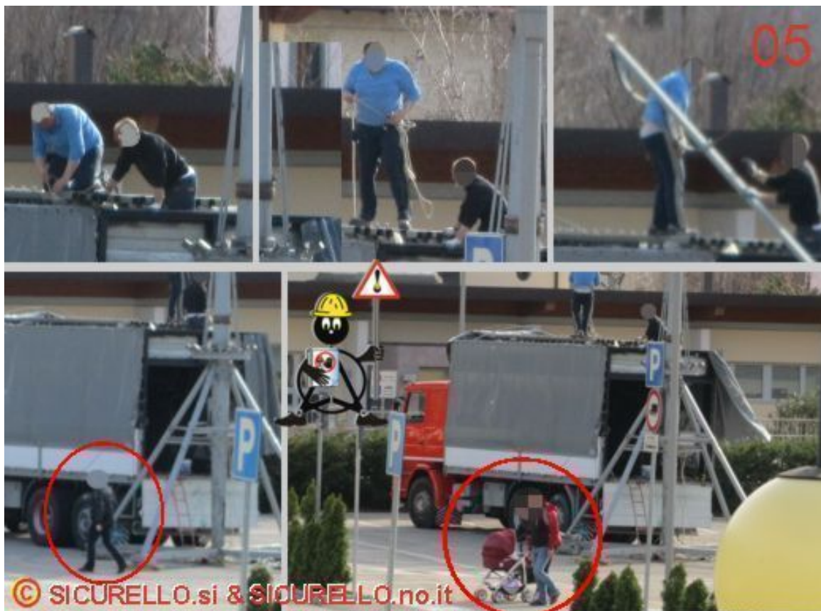
Foto 04 ? 05: Le attività continuano con gli operatori sempre a rischio caduta dall'alto e nel piazzale sottostante, senza alcuna limitazione e/o transenna, passano uomini, donne e bambini.
