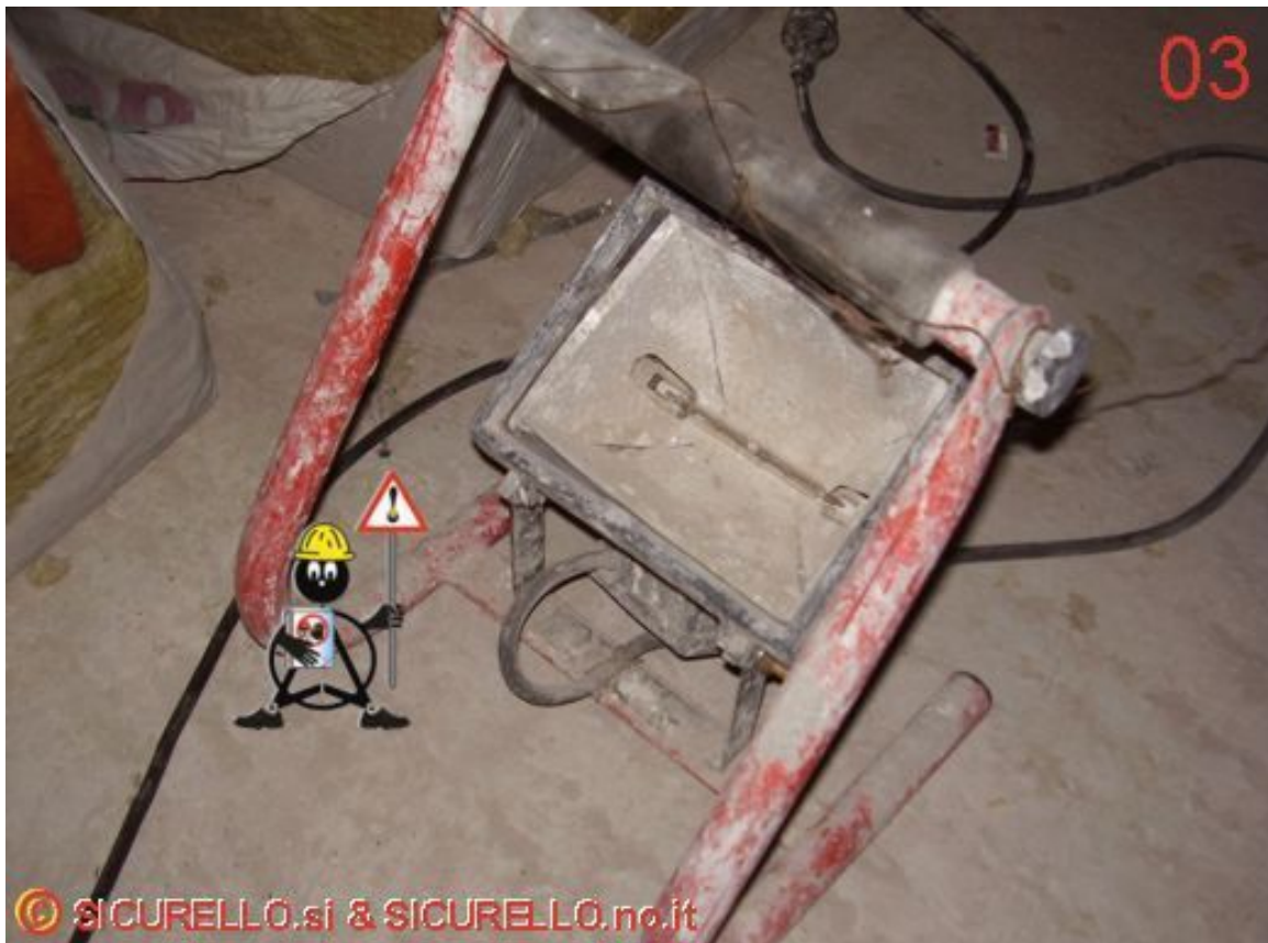
Foto 01 ? 02 - 03: lampade in cattivo stato di manutenzione con i conduttori non correttamente connessi al corpo lampada e/o con schermo di protezione rotto o non installate su appositi sostegni.
