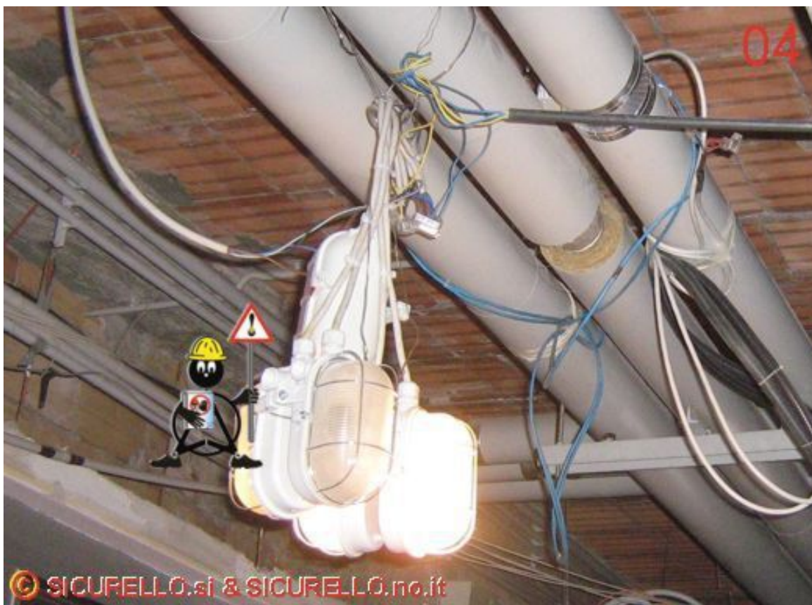
Foto 04: anche in questo caso i conduttori risultano non allacciati in modo idoneo ed inoltre le lampade risultano agganciate tramite i conduttori stessi e non con sostegni autonomi.
