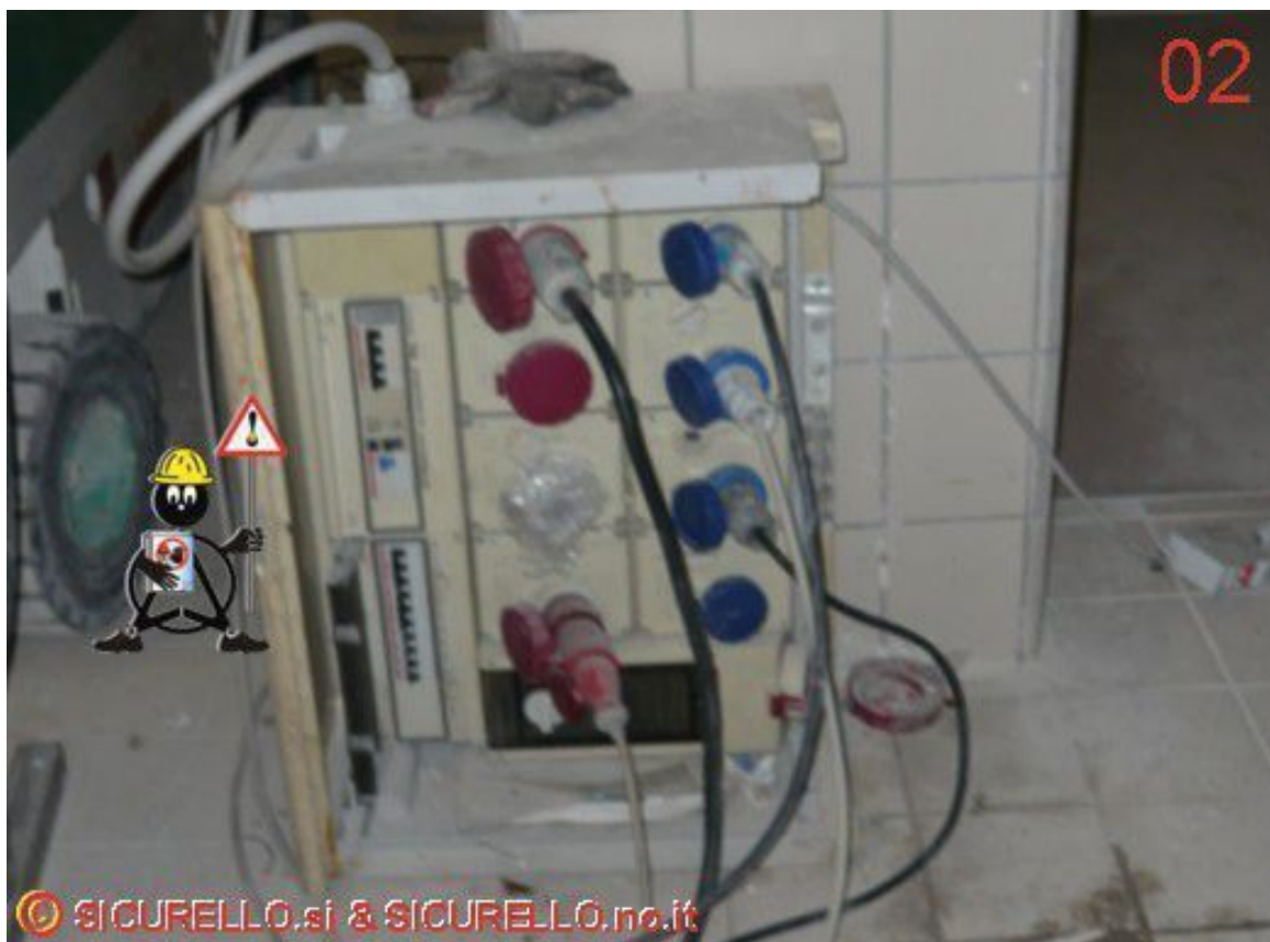
Foto 03: Altro quadro posizionato in modo scorretto (inutile dire che non rientra certamente nella categoria dei quadri ASC) e privo di ogni tipo di protezione da polvere, acqua, intonaci, urti, ecc.. Grado IP? Un bel 00
