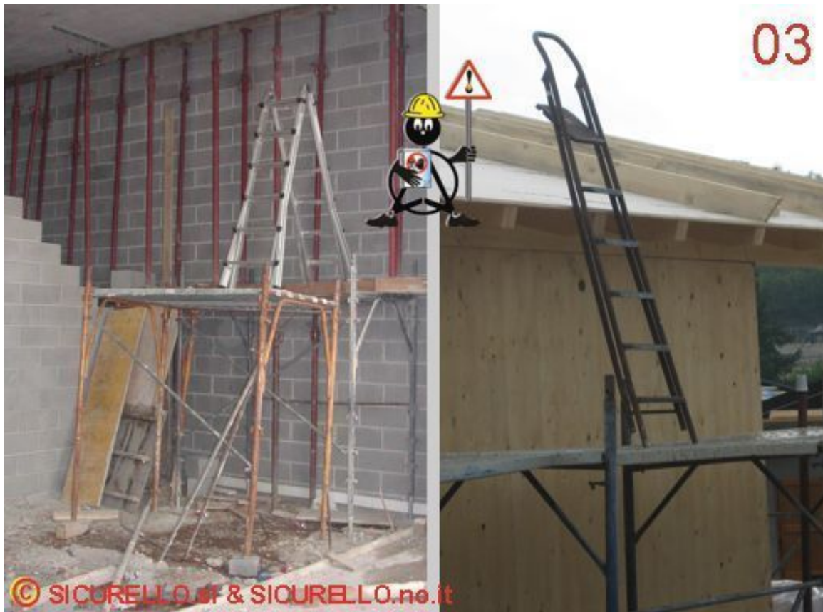
Foto 03: Il ponte a telai diventa la piattaforma per appoggiare una scala , il rischio caduta dall'alto è in agguato.
