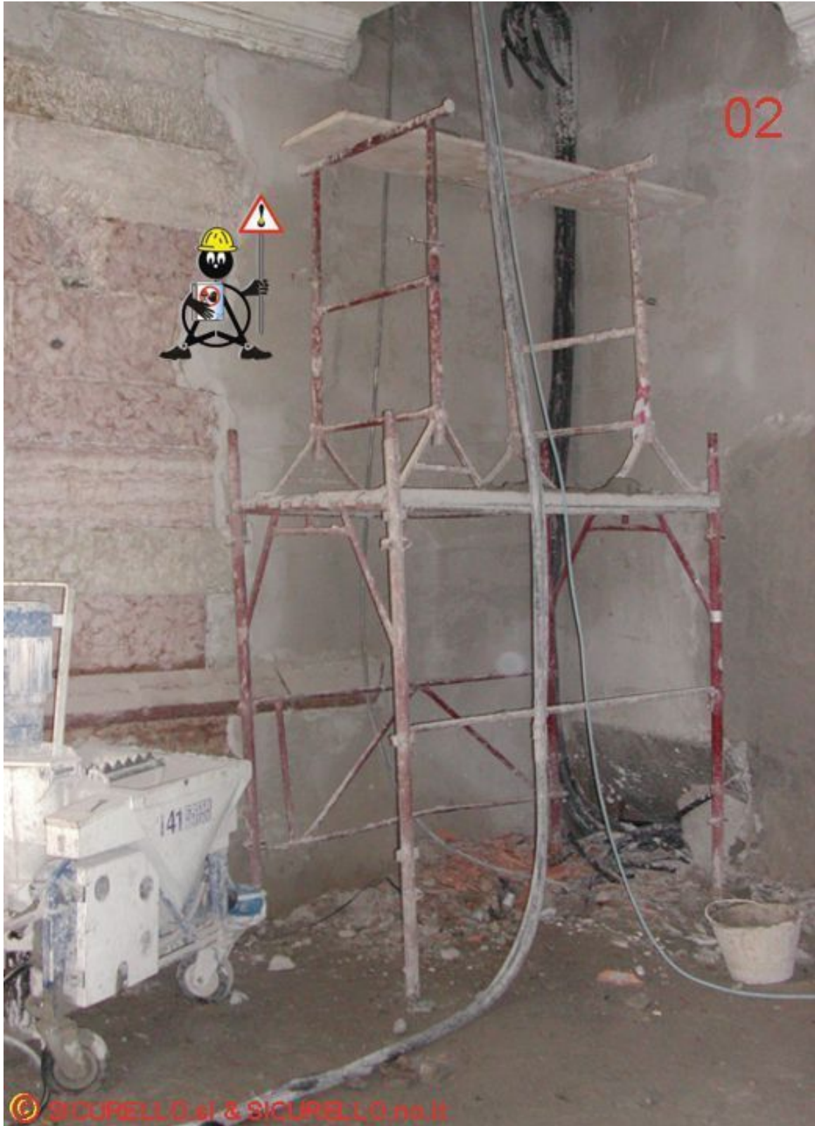
Foto 02: Al ponte a telai prefabbricati è stato sovrapposto un ponte su cavalletti. Un'insieme instabile.
