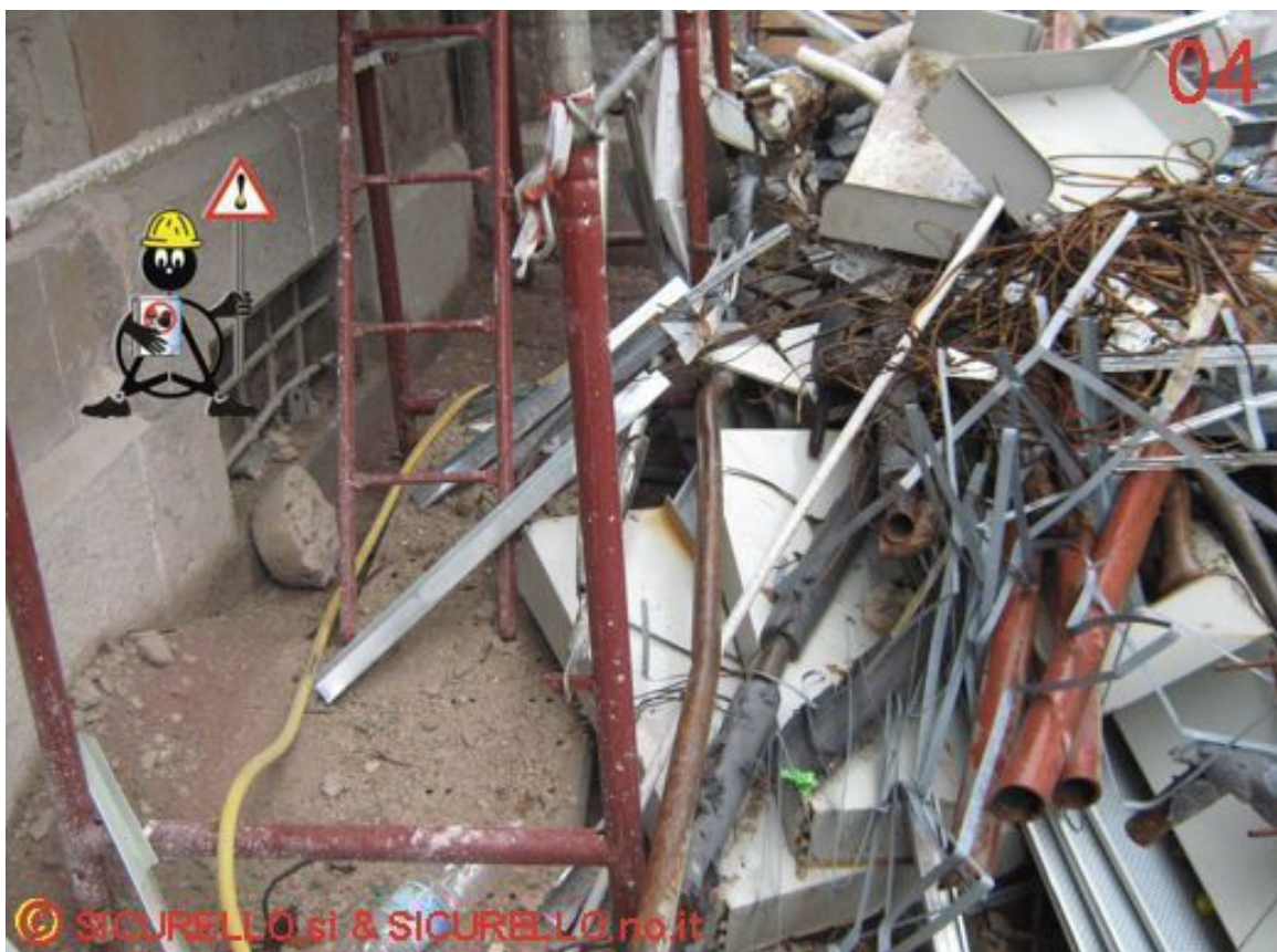
Foto 04: La base del ponteggio diventa una discarica. Vi è rischio che la base del ponteggio venga danneggiata durante le fasi di accatastamento e/o rimozione del materiale ed anche il rischio di danni agli operatori che utilizzano la scaletta di accesso al ponteggio.
