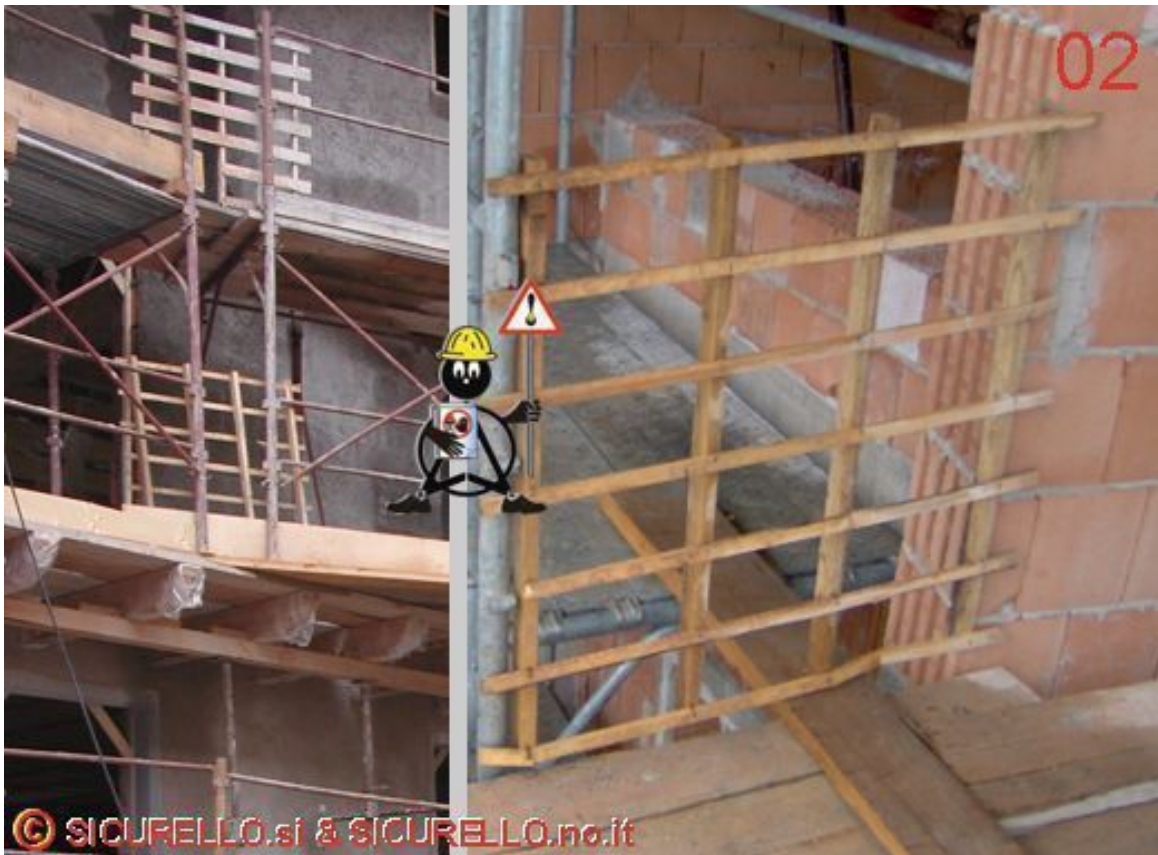
Foto 03: lo sbarco di un ponteggio su un solaio viene realizzato in maniera precaria, improvvisata ed incompleta.
