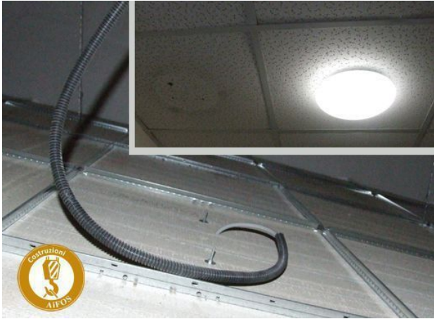
Figura 3 - Esempio di lampada montata in modo inidoneo ovvero direttamente sul pannello del controsoffitto. Da notare sul pannello di sinistra i segni inequivocabili di un precedente posizionamento del corpo illuminante. Lo spostamento della lampada era stato effettuato in quanto il pannello iniziava a cedere.
