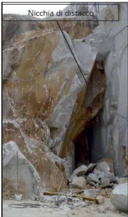
Foto 5 - "nicchia" dopo il distacco
