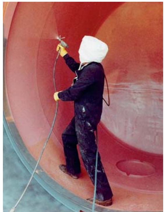
Fig. 6: le resine epossidiche sono una causa frequente di allergie cutanee. In caso di applicazione su una vasta superficie e soprattutto nei lavori di verniciatura a spruzzo, queste resine rilasciano vapori e aerosol che possono contaminare l'aria ambiente e scatenare un eczema. Per questo motivo è necessaria una protezione totale.
