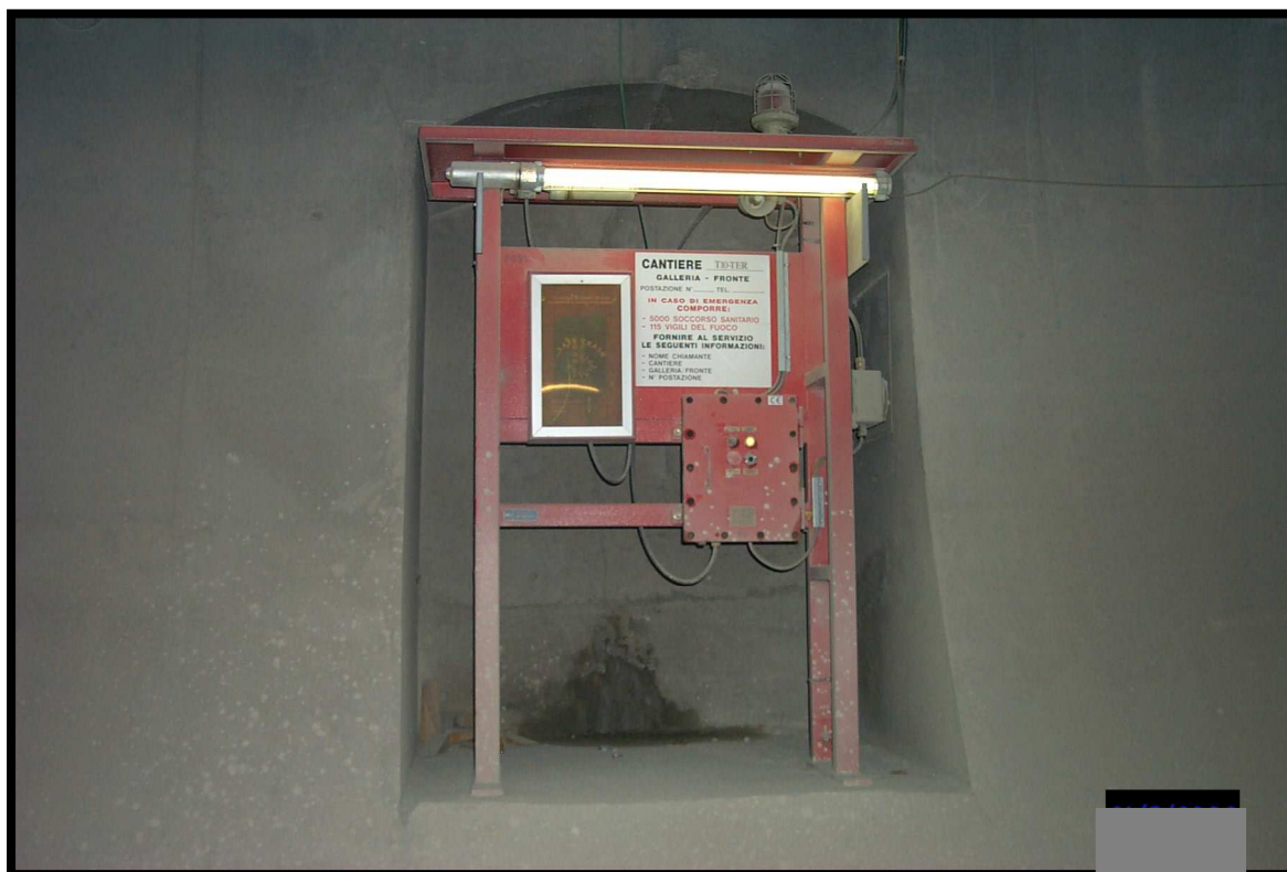
Fig.6: illuminazione postazione SOS all'interno della galleria (plaf. Fluor 2x40W autoalimentata tipo Eex-i)
